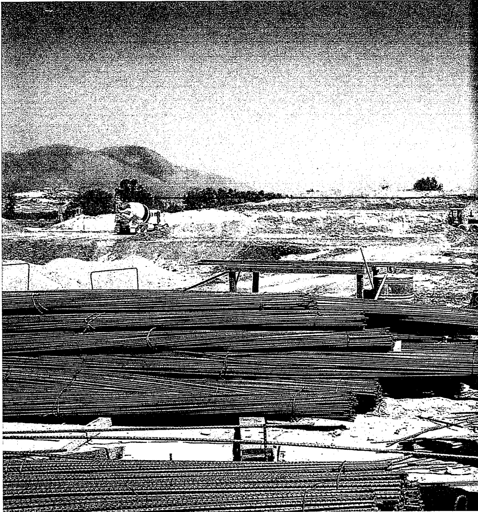
LAS MORITA PLANT – PHOTO 2
